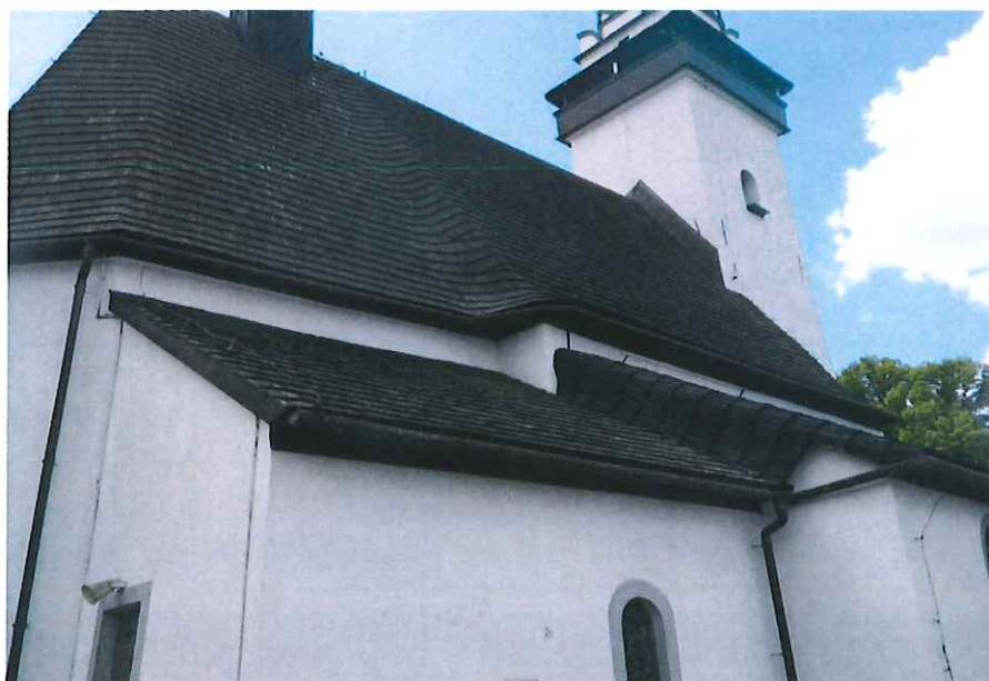
Widoczne ślady glonów i zniszczenia gontu –elewacja północna
