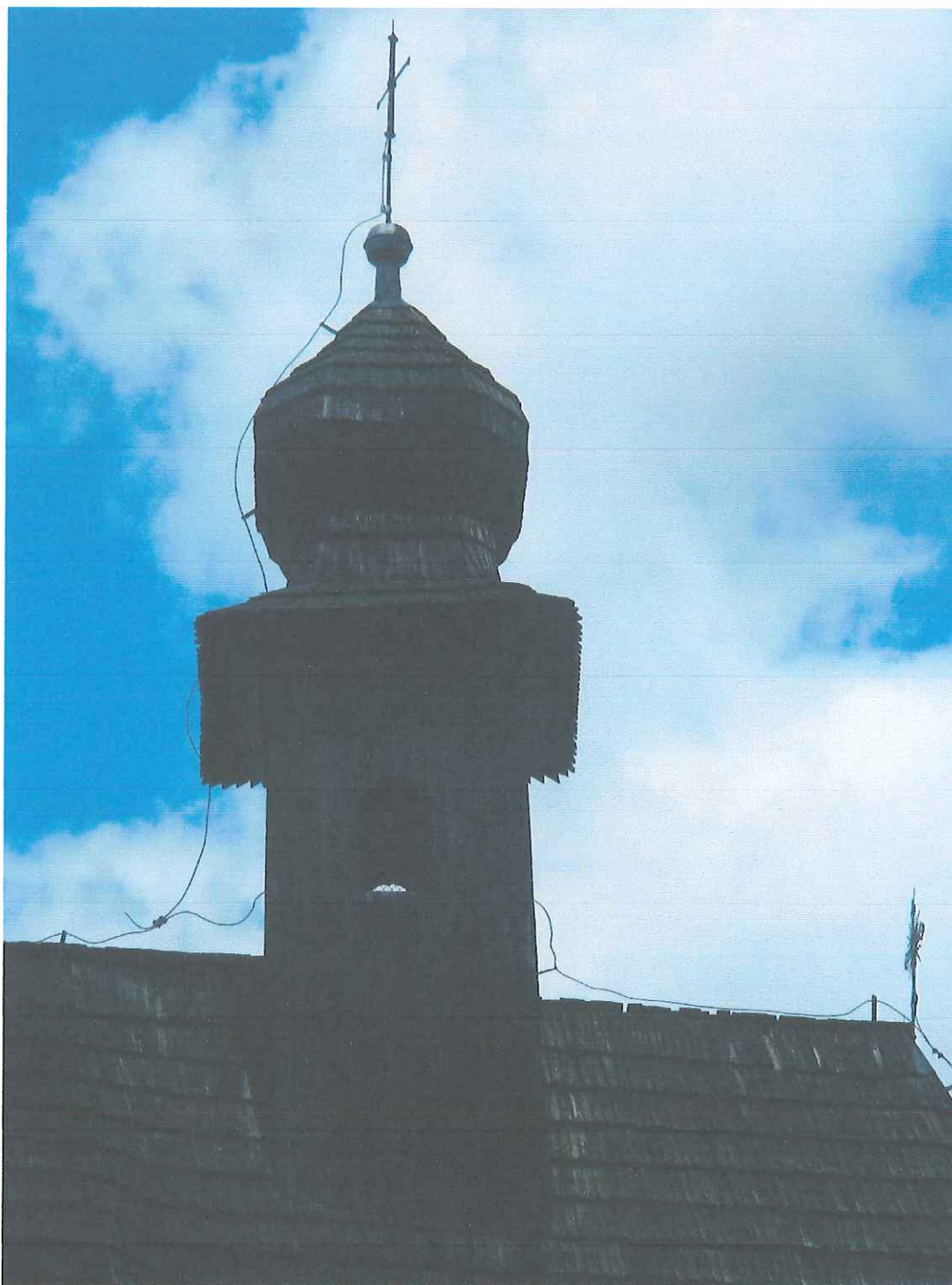
Fot 3. Krępachy, kościół parafialny pw. św. Marcina. Fragmenty gontowego pokrycia dachu . Fot B. Kulka, lipiec 2022r
