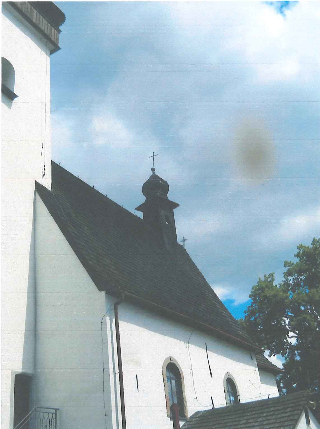
Fot 1. Krępachy, kościół parafialny pw. św. Marcina. Fragmenty gontowego pokrycia dachu . Fot B. Kulka, lipiec 2022r.
