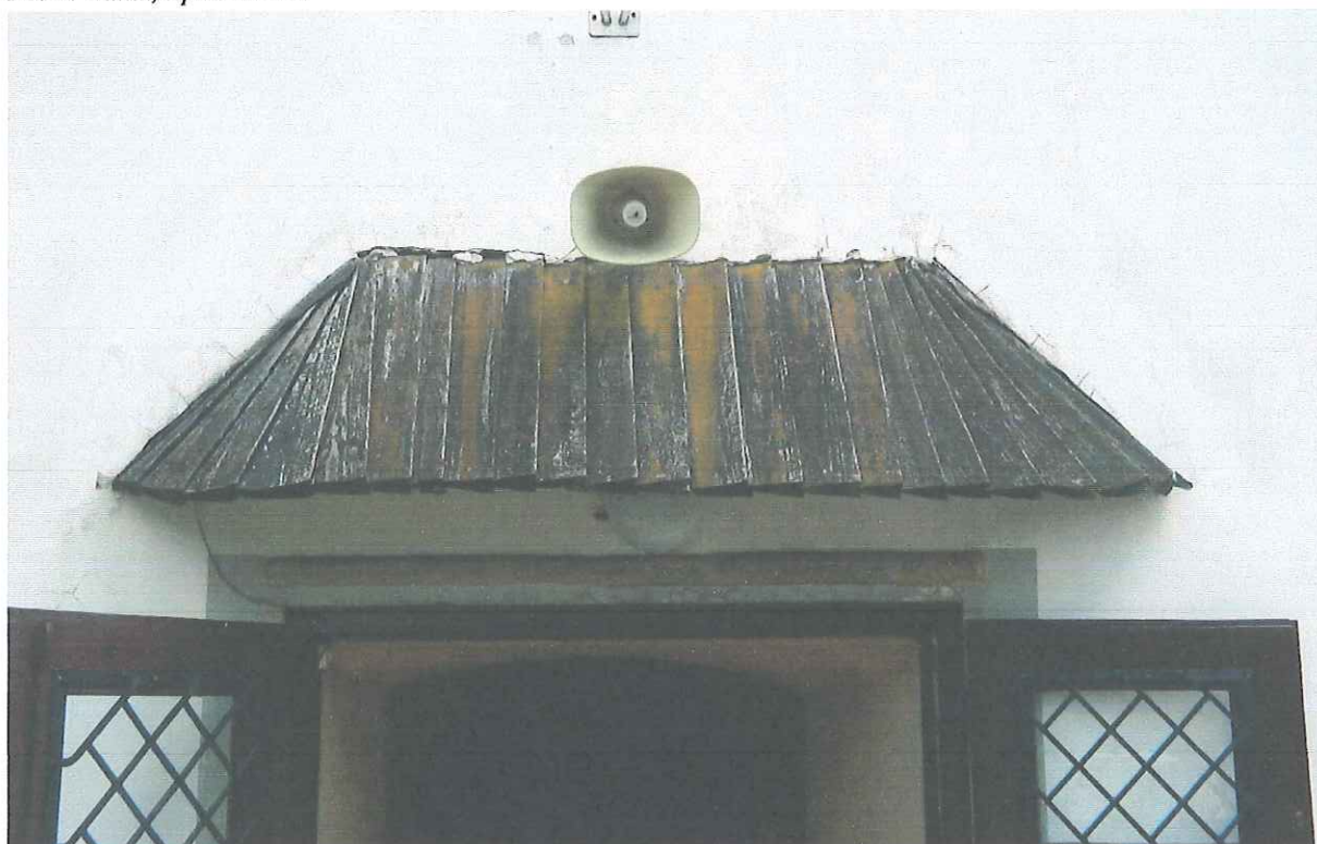
Fot 2. Kępachy, kościół parafialny pw. św. Marcina, Zadaszenie nad wejściem . Fot B. Kulka, lipiec 2022r.
