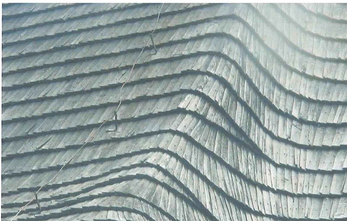
Fot 5. Krępachy, kościół parafialny pw. św. Marcina. Fragmenty gontowego pokrycia dachu . Fot B. Kulka, lipiec 2022r.
