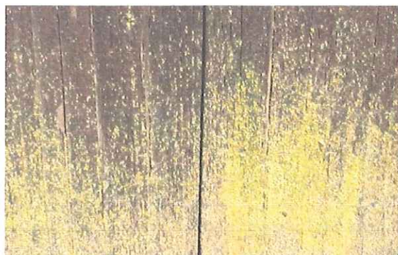
Fot 5. Krępachy, kościół parafialny pw. św. Marcina, fragment dachu, widoczne przebarwienia organiczne. Fot B. Kulka, lipiec 2022r.
