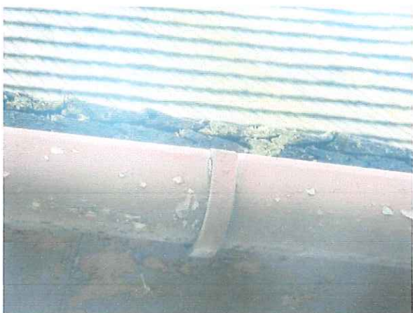
Fot 3. Krępachy, kościół parafialny pw. św. Marcina, fragment dachu, widoczne zniszczone klepki. Fot B. Kulka, lipiec 2022r.
