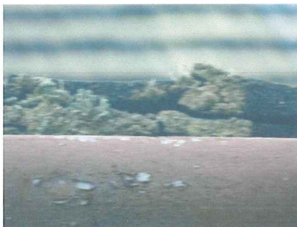
Fot 4. Krępachy, kościół parafialny pw. św. Marcina, fragment dachu, widoczne zniszczone klepki. Fot B. Kulka, lipiec 2022r.
