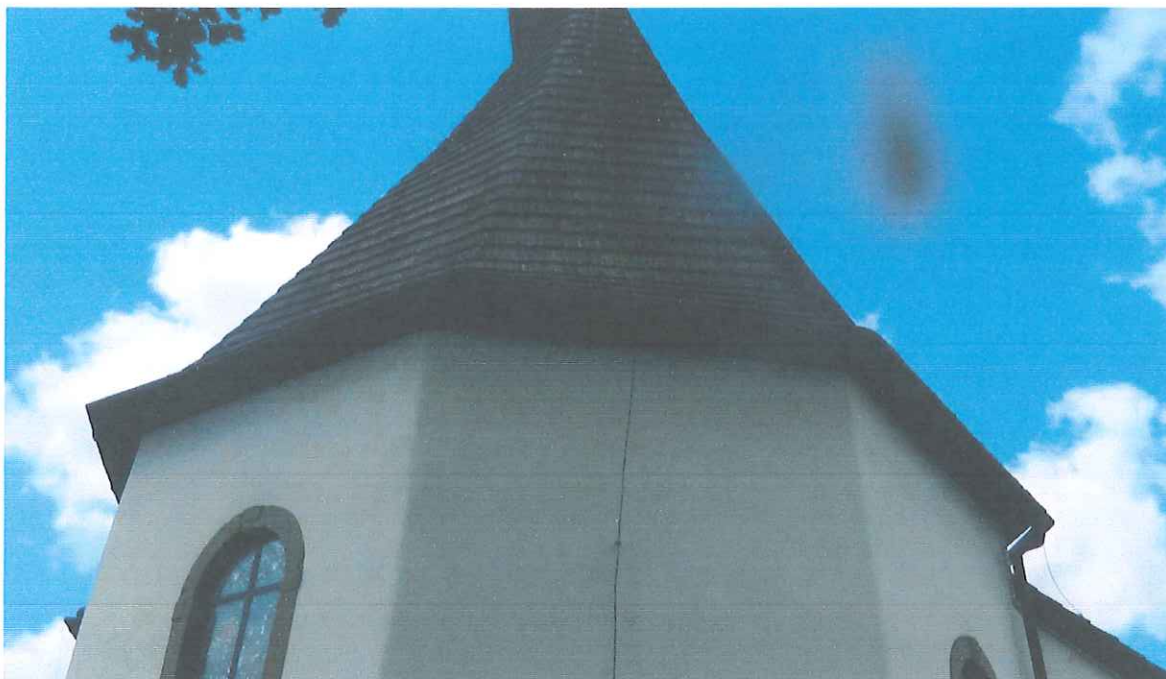
Fot 4. Krępachy, kościół parafialny pw. św. Marcina. Fragmenty gontowego pokrycia dachu . Fot B. Kulka, lipiec 2022r.
