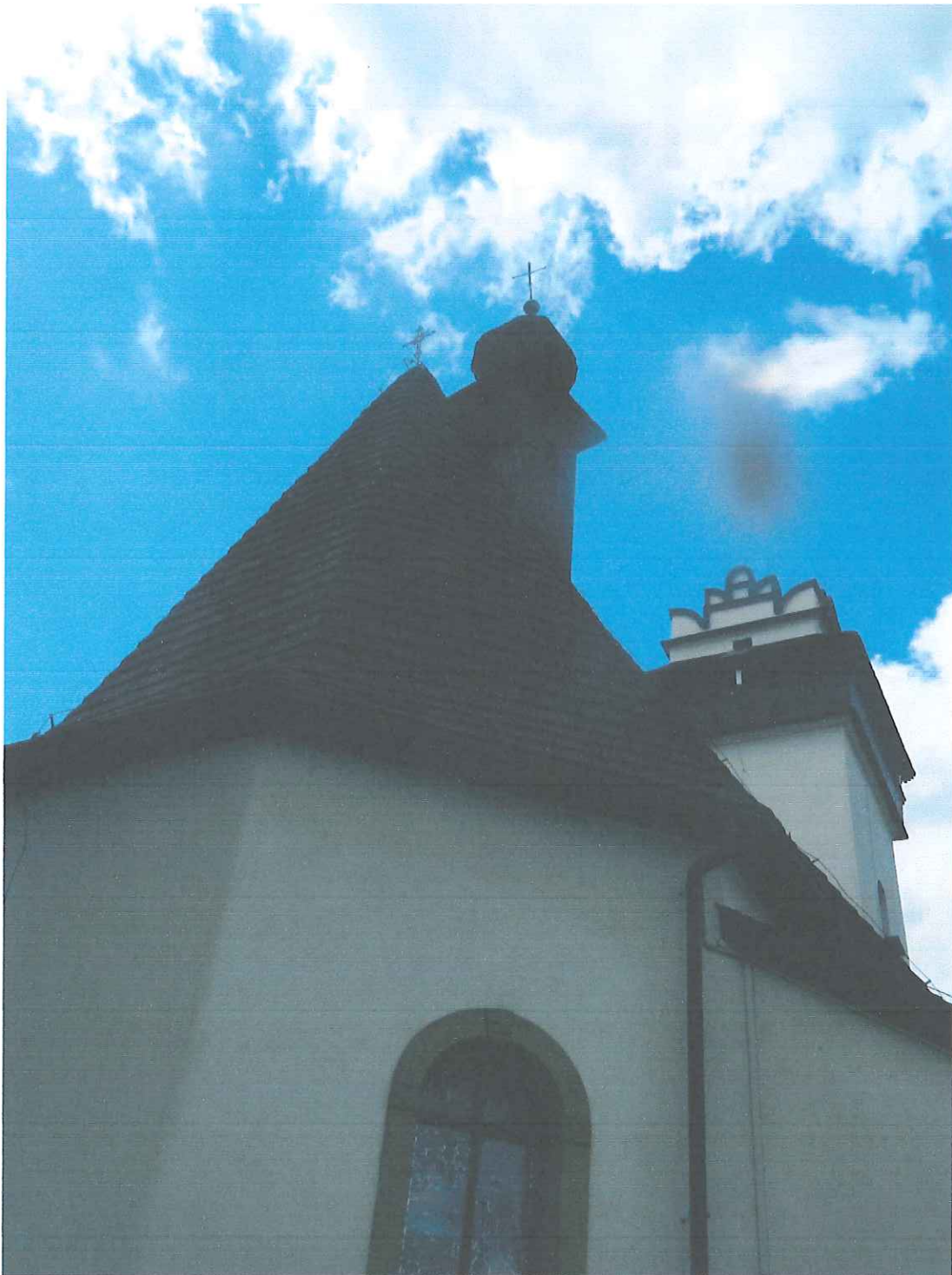
Fot 2. Kępachy, kościół parafialny pw. św. Marcina. Fragmenty gontowego pokrycia dachu . Fot B. Kulka, lipiec 2022r.
