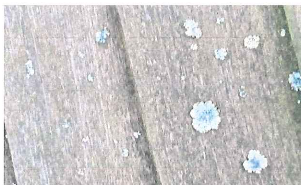
Fot 6. Krępachy, kościół parafialny pw. św. Marcina, fragment dachu, widoczne wykwyty grzybow. Fot B. Kulka, lipiec 2022r.
