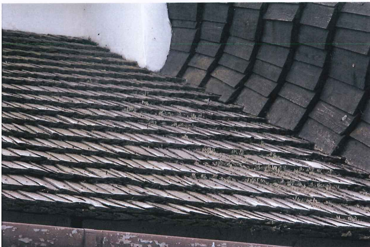
Fot. 5,6 – Zły stan pokrycia dachu z drewnianych łupanych gontów na kościele – widok ogólny
