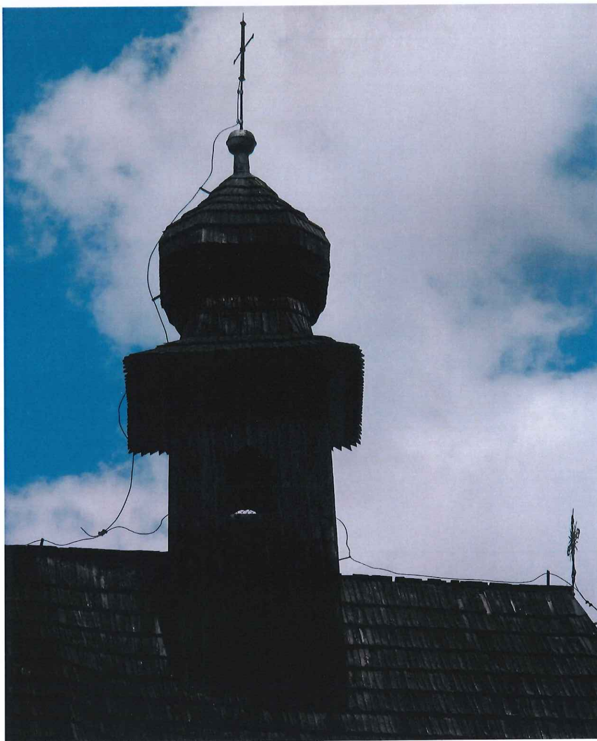
Fot. 1 – Zły stan pokrycia dachu z drewnianych łupanych gontów na kościele – widok ogólny, widoczne korozja biologiczna gontów i deskowania ścian bocznych sygnaturki
