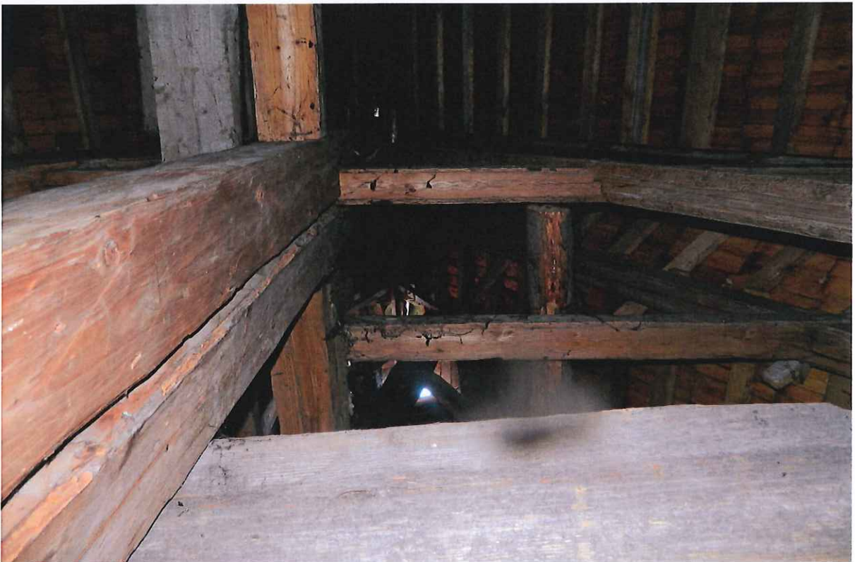
Fot. 12,13 – Wieżba dachowa wymagająca prac konserwatorskich
