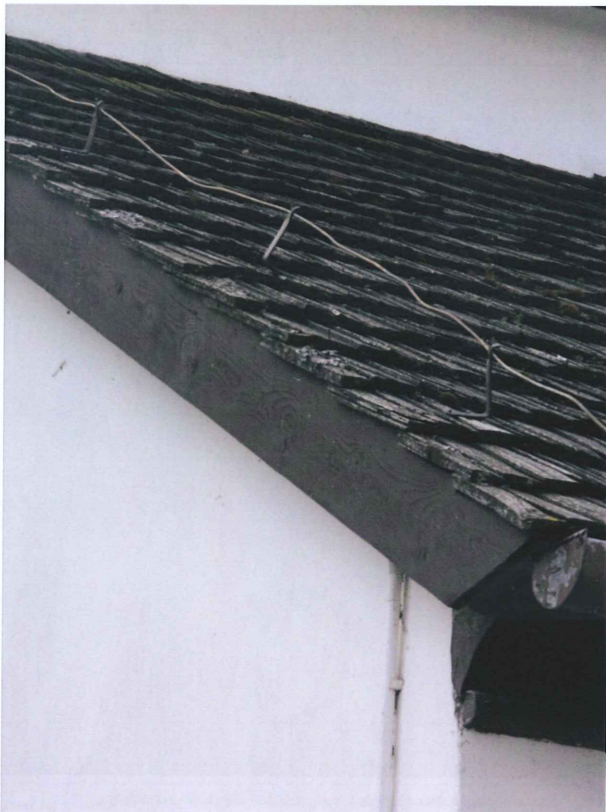
Fot. 4 – Zły stan pokrycia dachu z drewnianych łupanych gontów na kościele – widok ogólny
