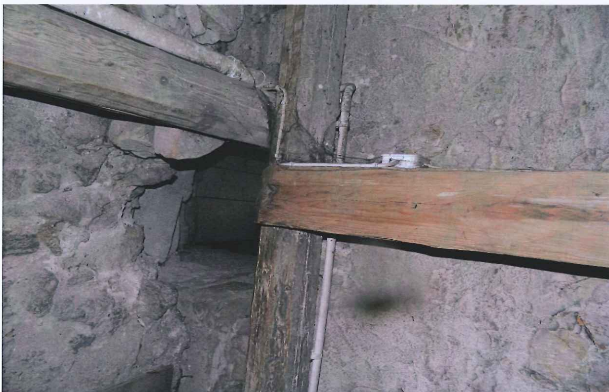
Fot. 14,15 – Więźba dachowa wymagająca prac konserwatorskich
