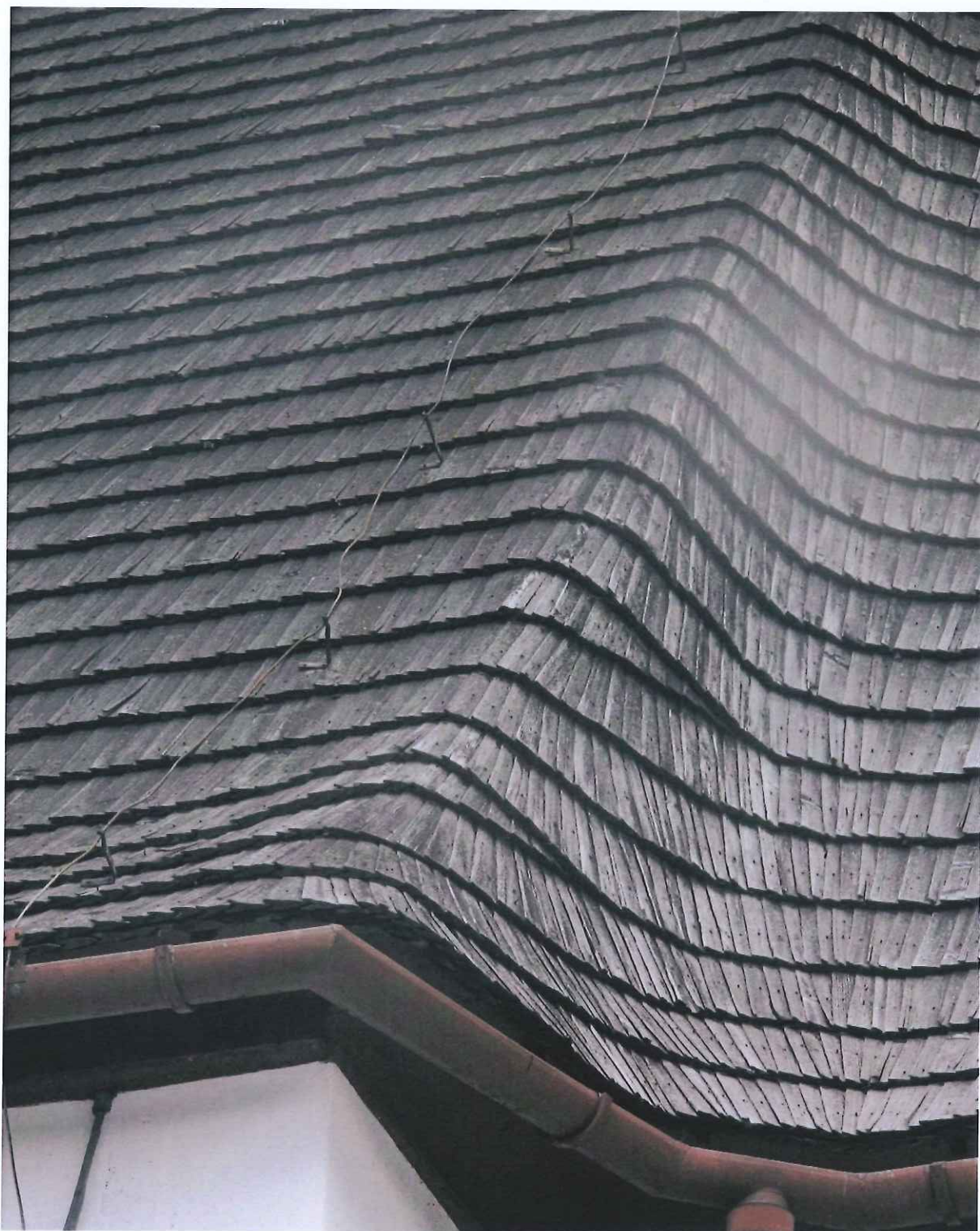
Fot. 2 – Zły stan pokrycia dachu z drewnianych lupanych gontów na kościele – widok ogólny
