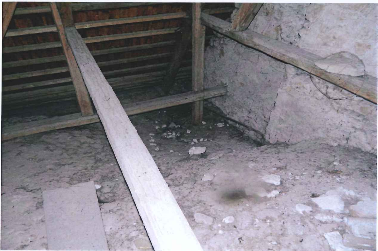
Fot. 10,11 – Więźba dachowa wymagająca prac konserwatorskich
