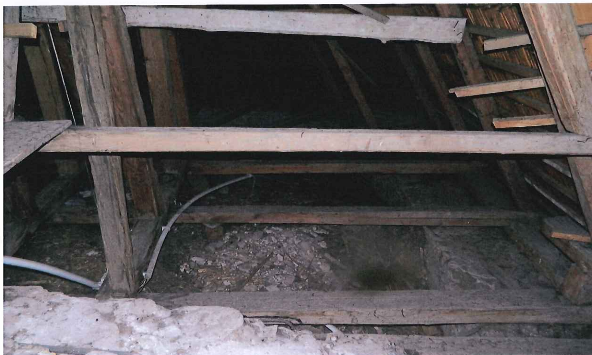
Fot. 16,17 – Więźba dachowa wymagająca prac konserwatorskich
